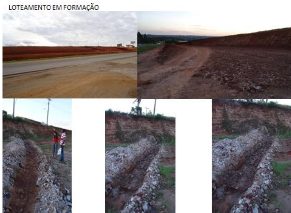
Figura 6-4 - Retirada da cobertura vegetal (área de plantio) e escavações sem critério para o lançamento de redes de drenagem pluvial.
