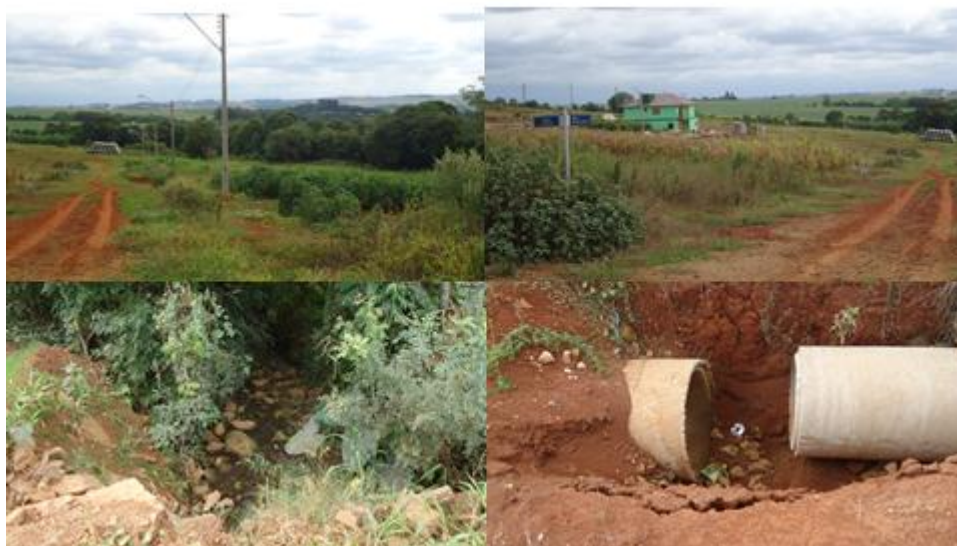
Figura 6-7 - Corpo receptor (arroio), construção descriteriosa de rede pluvial, detalhes da zona urbana em área sem pavimento.
