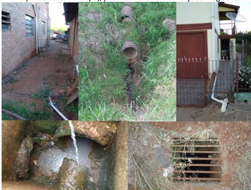
Figura 4-2 – Ligações de esgoto sanitário ou água cinza (de lavatórios, chuveiro e máquinas de lavar roupa), possivelmente em condições irregulares.
