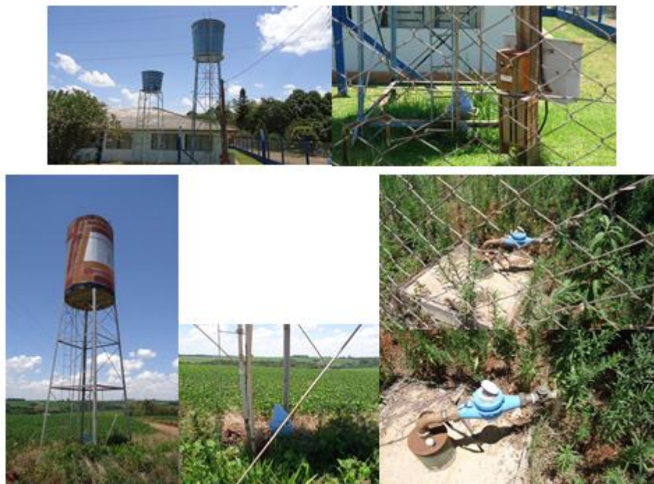
Figura 3-9 - Equipamentos do Sistema de Abastecimento de Água de Tio Hugo.
