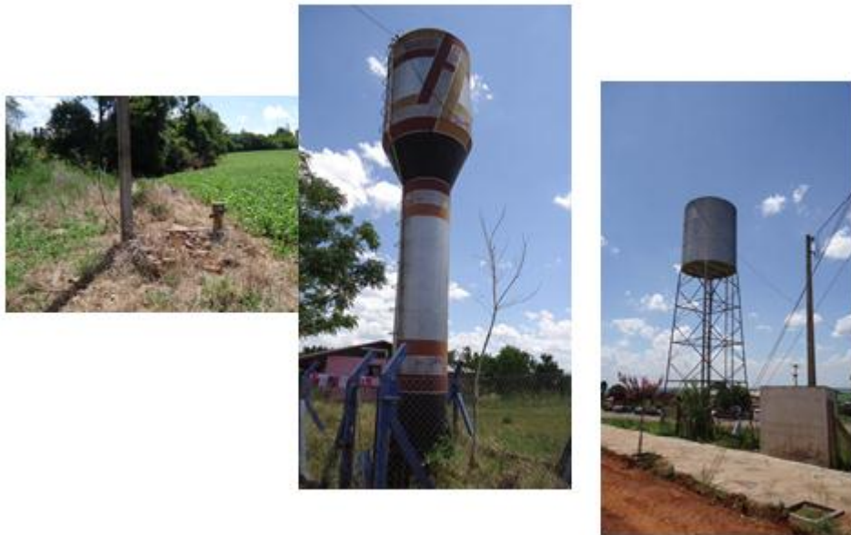
Figura 3-11 - Equipamentos do Sistema de Abastecimento de Água de Tio Hugo.
