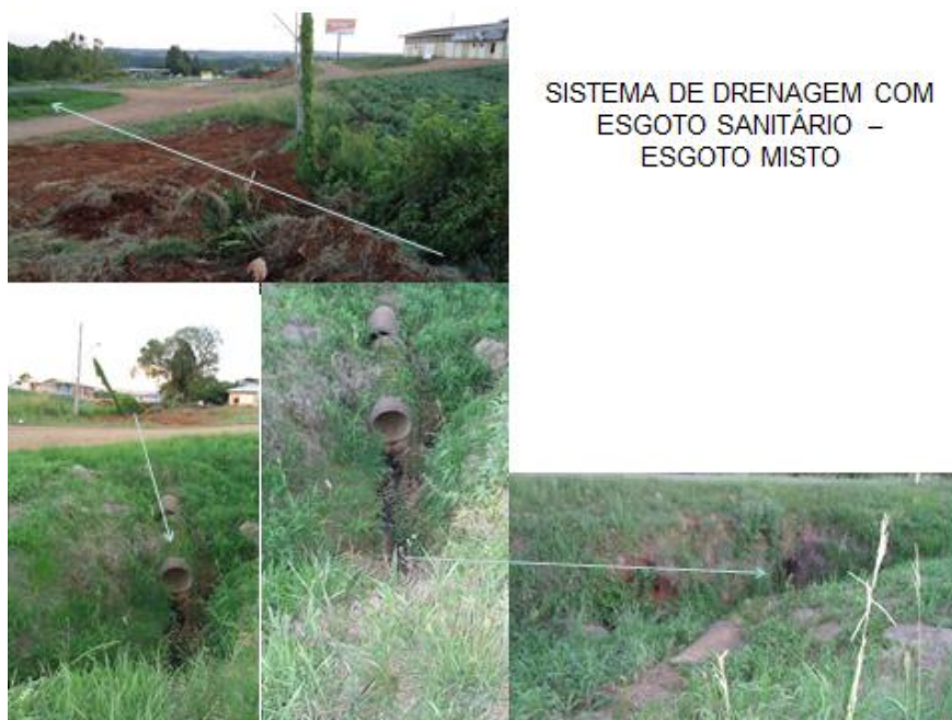
Figura 6-3 - Indicativos do lançamento de esgoto sanitário nas redes do sistema de drenagem pluvial.
