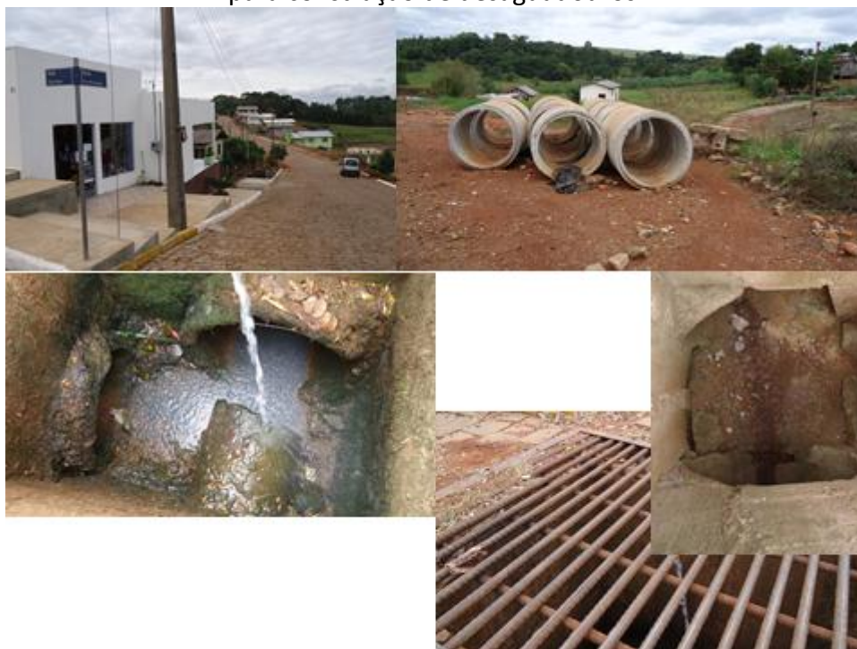
Figura 6-6 - Travessias, pontos de lançamento irregular de água cinza, grelhas, tubulações para construção de desaguadouros.
