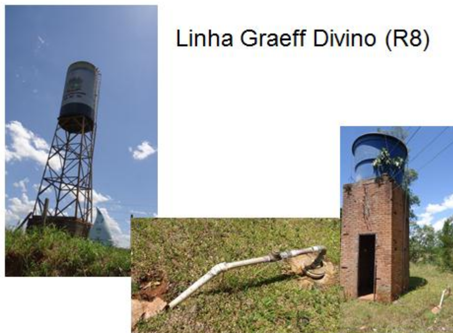
Figura 3-12 - Equipamentos do Sistema de Abastecimento de Água de Tio Hugo.
